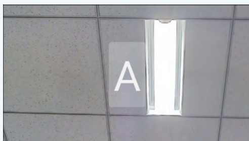
(例) 蛍光灯を点けた室内
